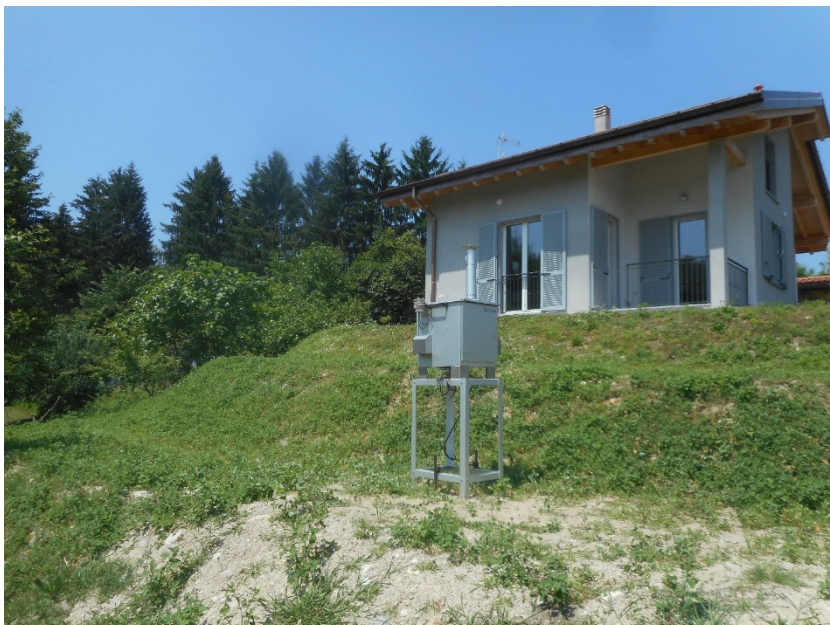
Fig. 3 Stazione di monitoraggio B (Loc. Pacit, Comune di Ternate)
